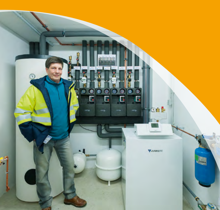
> Beispielbild einer Vlotho Nahwärme -Übergabe-Station
